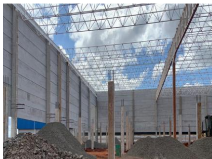
PAINÉIS DE CONCRETO
